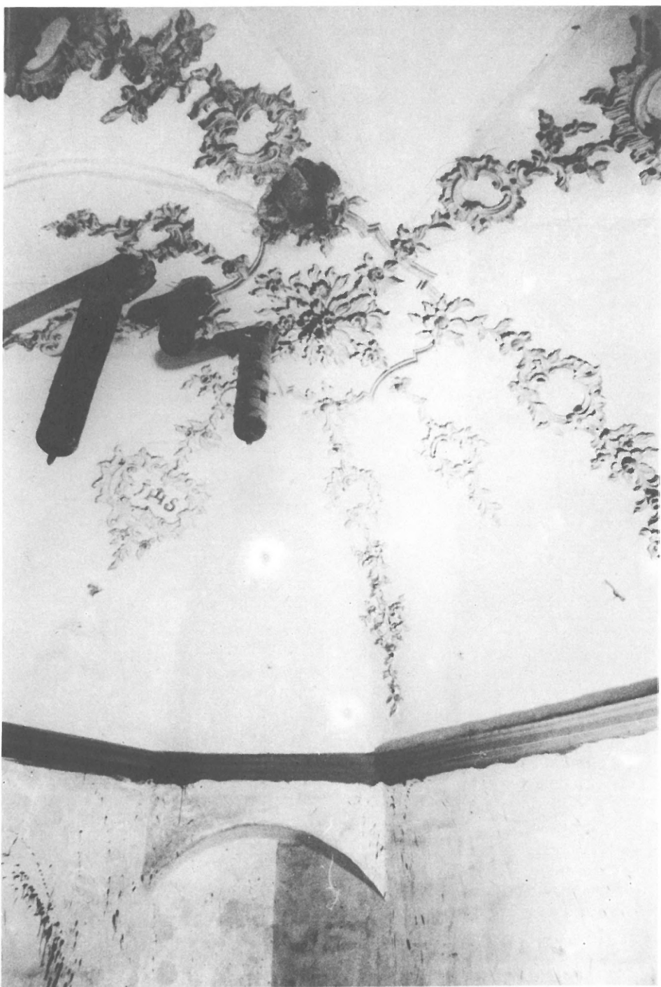
Lámina VIII. Torre de la Iglesia de S. Juan. Vélez-Málaga. Estancia del 4 o piso.
