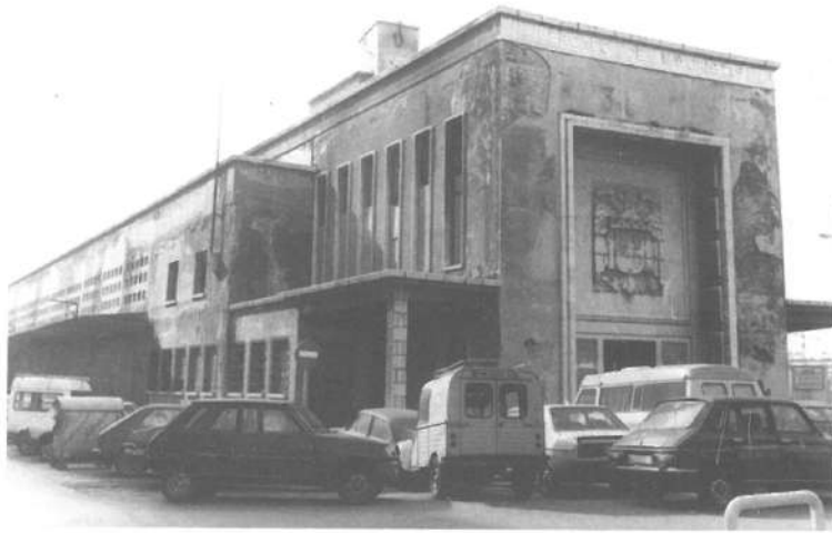
Lám. 1.- Mercado de Mayoristas. Málaga. Fachada Principal. Estado de Conservación.
