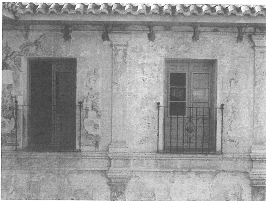
Fig. 9.—Detalle del estado de conservación general e inicio de los tratamientos de descubrimiento. (foto J. de Llarena).
