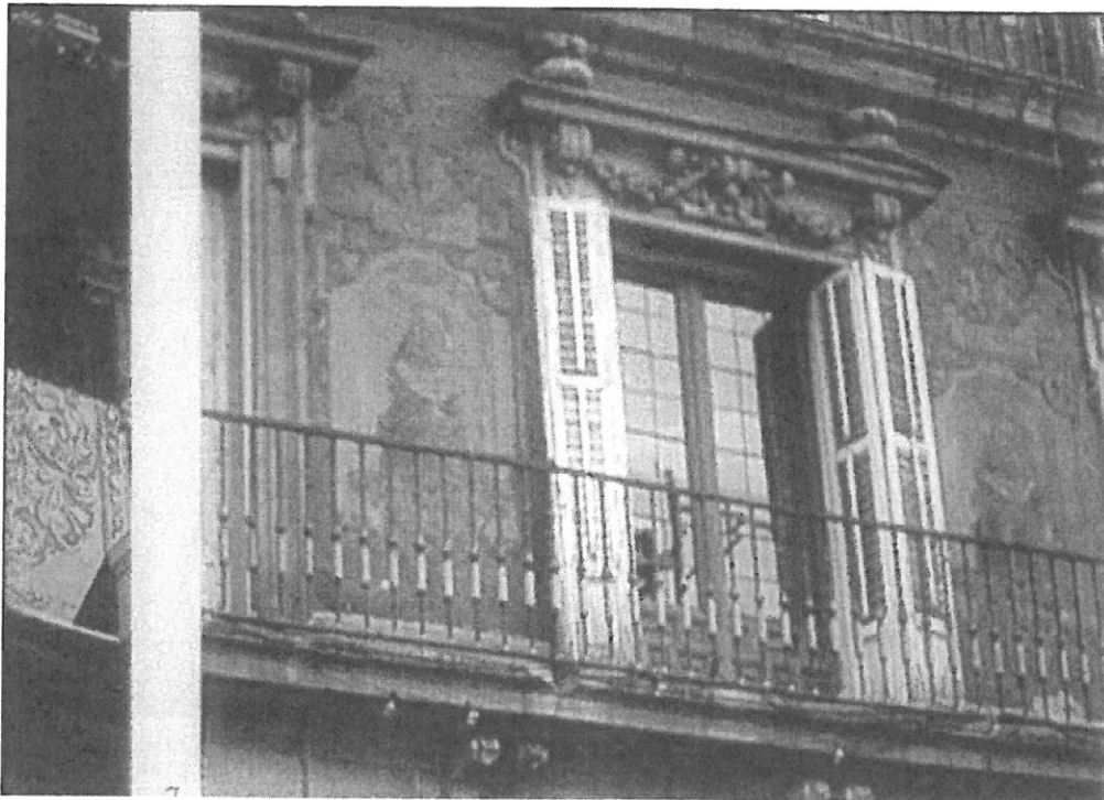
Figs. 13 y 14.— Decoración mural de la fachada de la Casa de la Panadería, antes y después del tratamiento. Madrid, Plaza Mayor.
