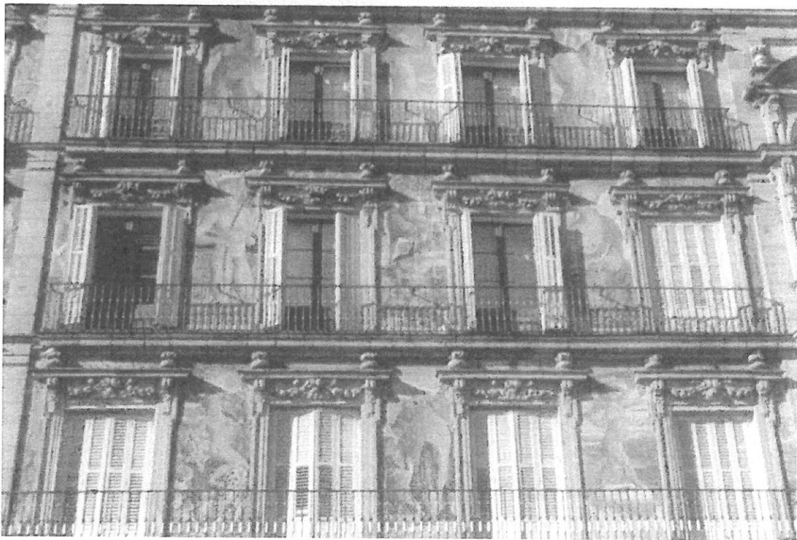
Fig.15.— Pérdida de revoco. Fachada del Madrid de Los Austrias.
