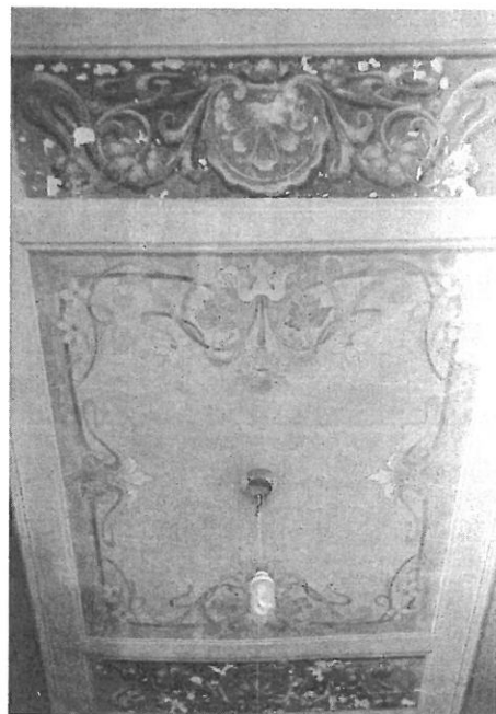
8.- Salinas, 10. Pinturas techo portal.
